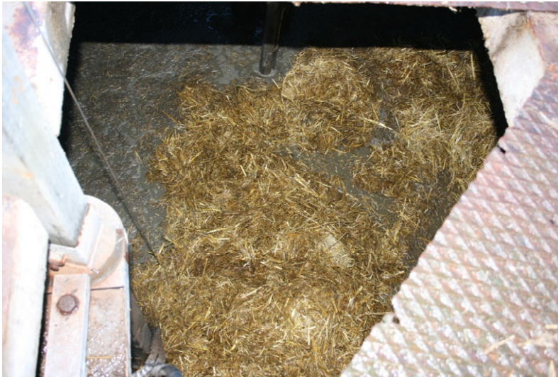
Bild 2. Under grisning används ofta rikligt med halm. Då mycket halm hamnar i pumpbrunnen kan det bli svårt att pumpa gödsel till lagringsbrunnen.
