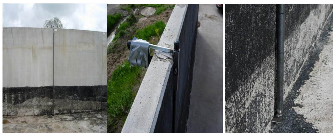
Figur 3. Placering av pressvattenrör längs silovägg, detalj av rörhållare och rörpropp samt rörslitsar 0,26 m och 0,46 m från silobotten (slitsvidd ca 1,1 mm).
